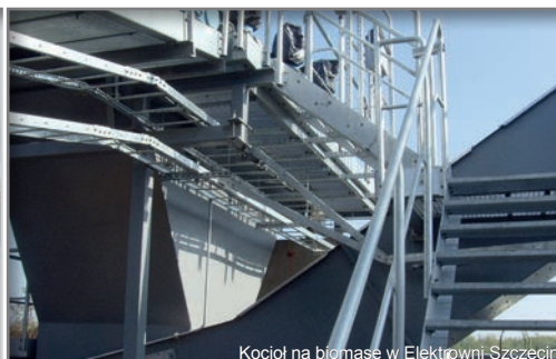
Kociół na biomasę w Elektrowni Szczecin
